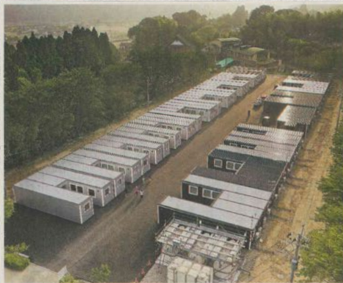
熊本県球磨村の総合運動公園内に設置された、トレーラーで運搬可能な「ムービングハウス」の仮設住宅=2020年8月
