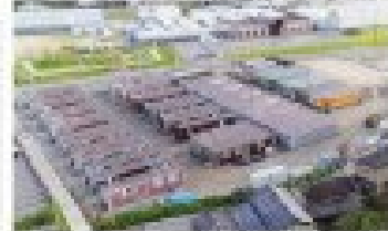
モバイル型仮設住宅の建設現場。建設から撤去まで、わずか数日で完了できる。
